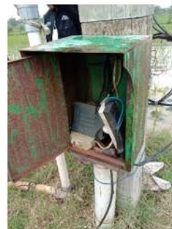
Gambar 2. Kondisi unit pesaklaran saat peninjauan.
